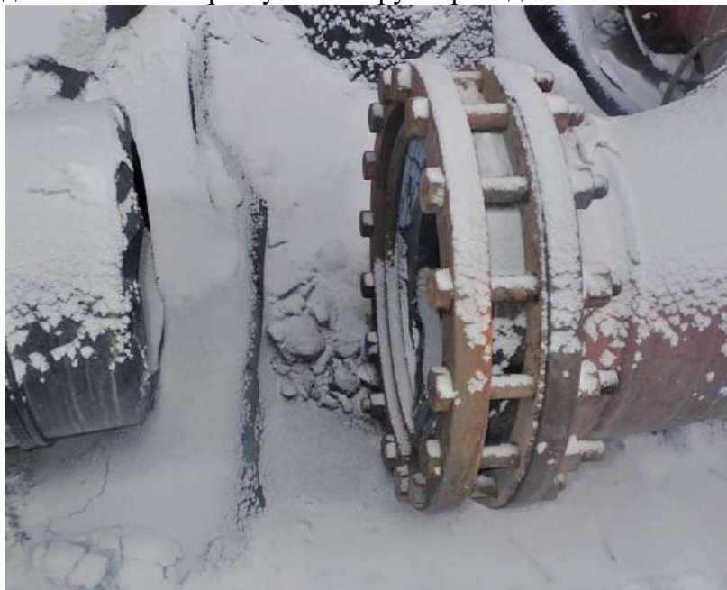
Рис. 1. Разрыв трубы произошел на участке фланцевого соединения трубопровода
