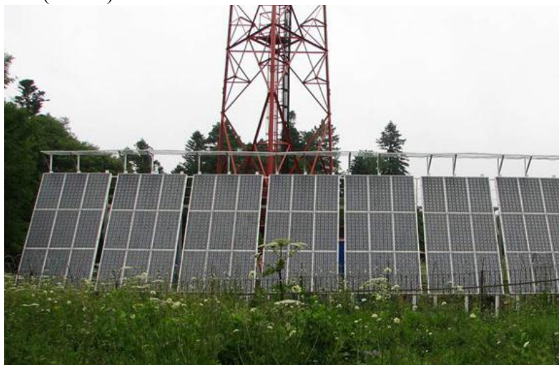
Рис. 4. Первая базовая станция, работающая на солнечной энергии и дизеле
