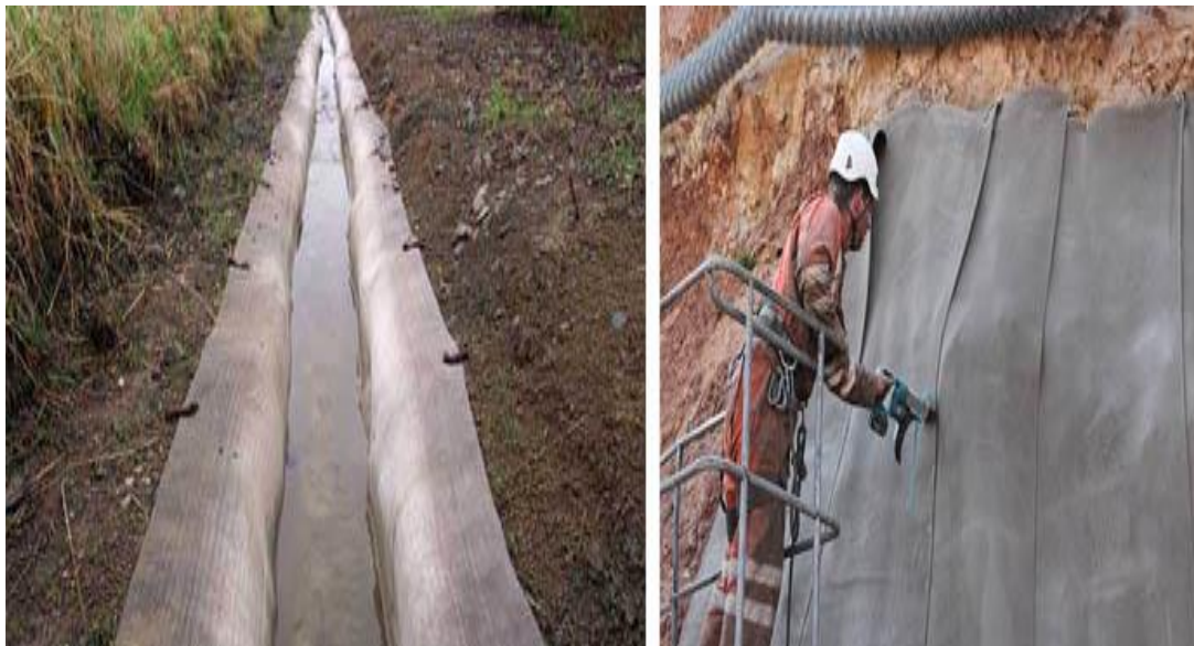
Рис. 1. Использование бетонного полотна: а) в виде арыка; б) укрепление и защита склонов.
