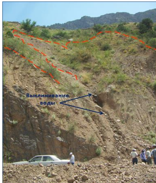
Рисунок 3. Оценка устойчивости откоса автомобильной дороги Бишкек-Ош
