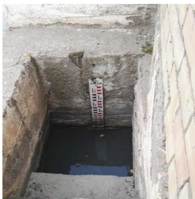
Рис.1 Успокоительный колодец на гидросту «Аламедин»
